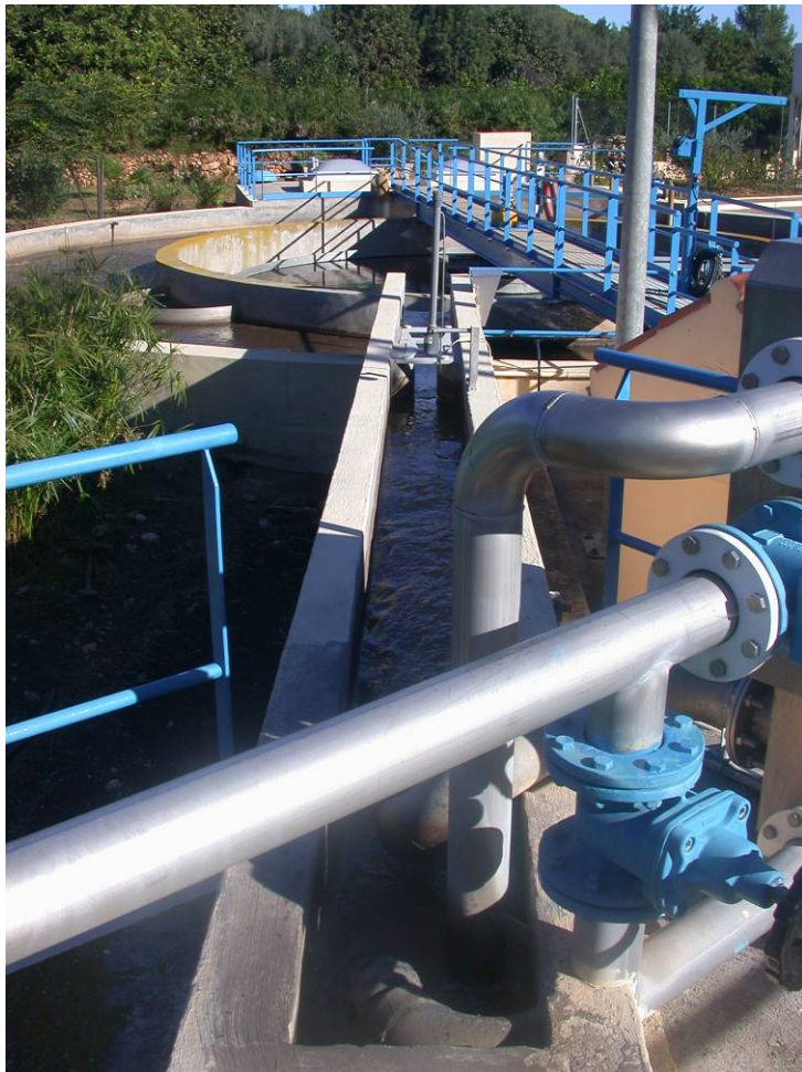
Detalles de las fases de depuración
